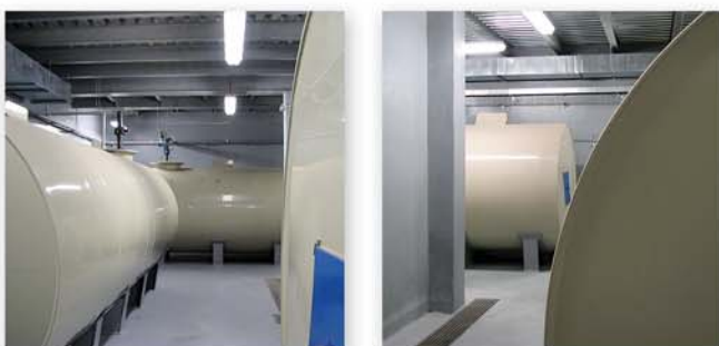
ZÁSOBNÍ NÁDRŽE NA VODU A CHEMII
